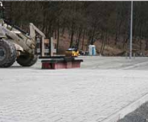
Sable sur pavés autobloquants
